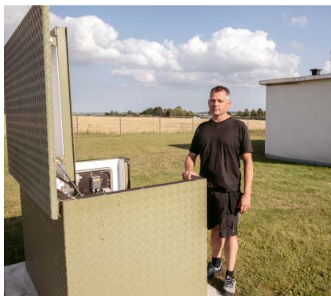
Torben Hovmand ved boringen tættest på vandværket, som for et par år siden blev udstyret med ny teknik. Generelt er Tuse Næs Vandværk godt med, når det gælder moderne udstyr og anlæg. Foto: Ulrik Larsen
